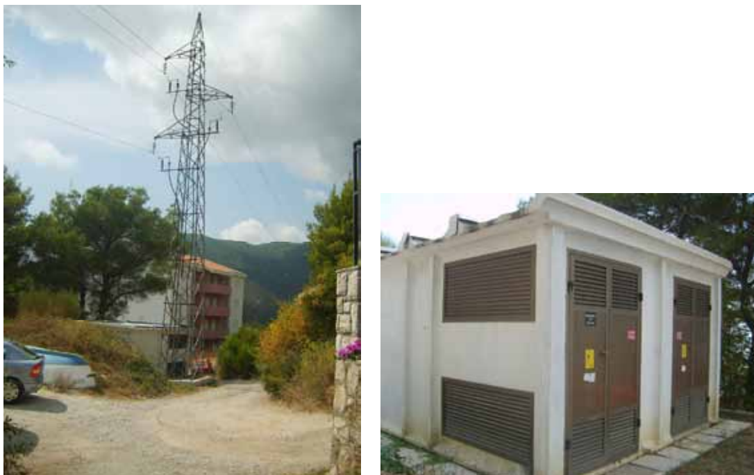
Slika 2. TS 10/0.4 kV, 1x630 kVA i rasklopište 35 kV „Vrh Lazi”
