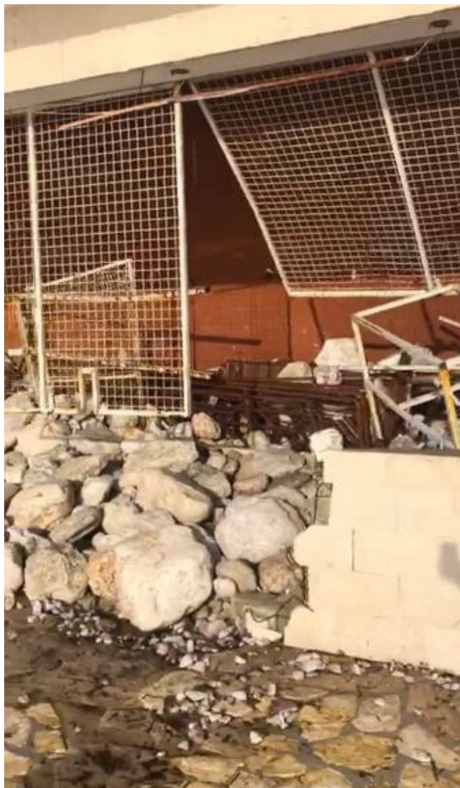
Slika 33. Šteta nastala na objektu na obuhvatu južne (istočne) plaže tijekom nevremena
