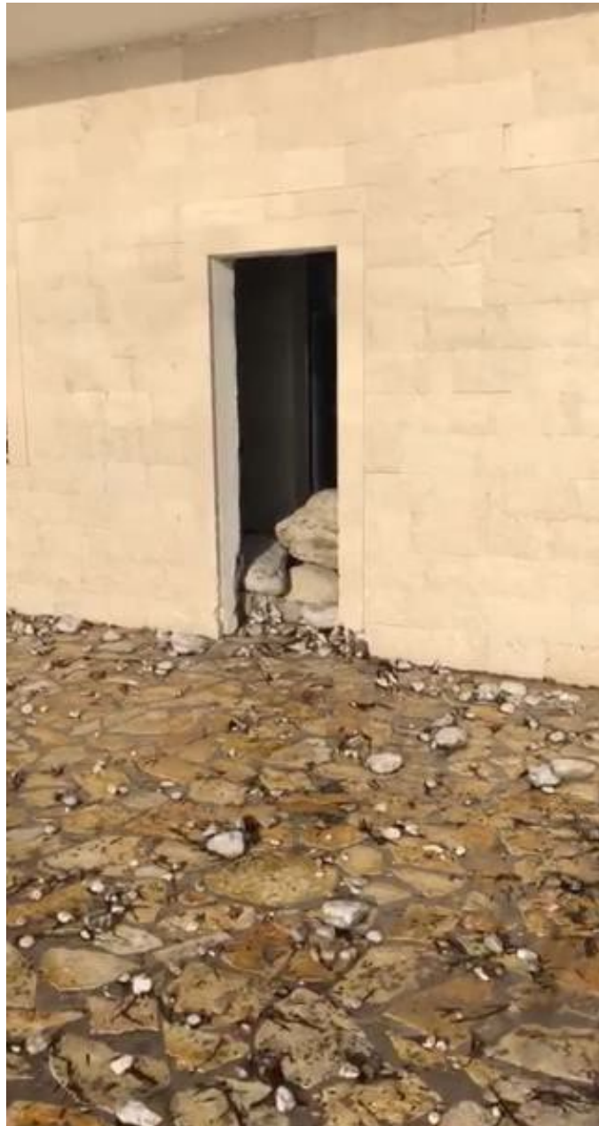
Slika 34. Uništeni sanitarni čvorovi
